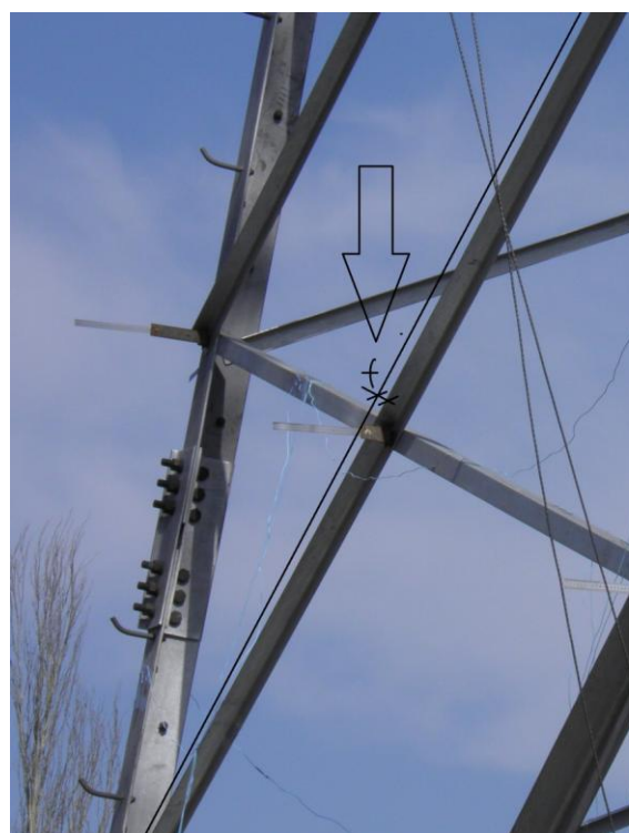
Рисунок 9 - Фиксирование выгиба решетки нижней части опоры
