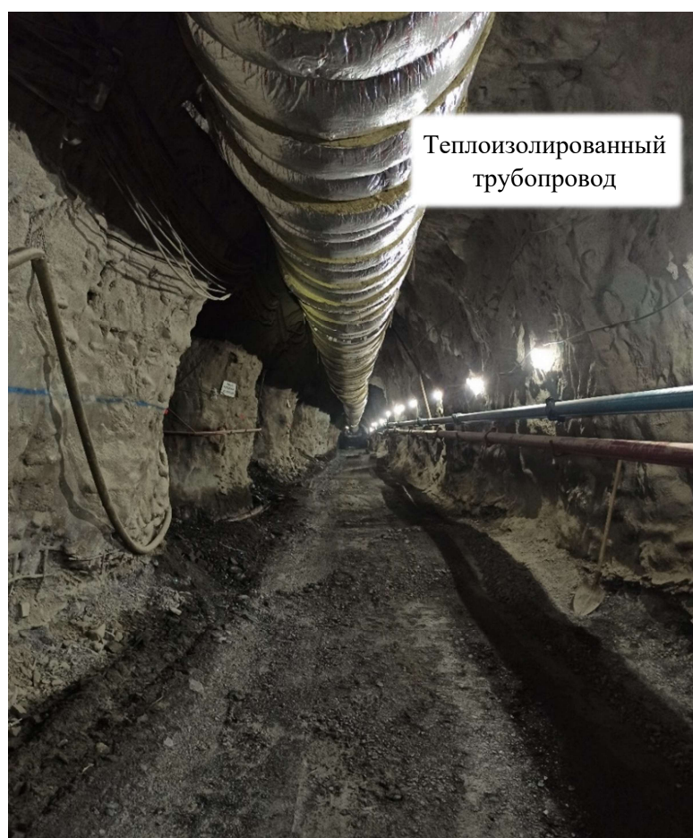
Рисунок 11 — Теплоизолированный трубопровод применяемый в выработке
