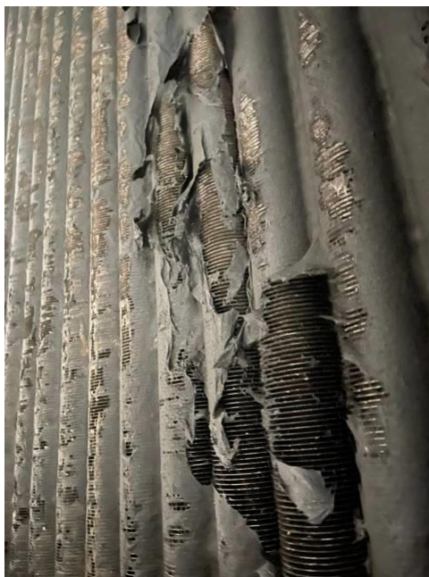
Рис. 2. Загрязнение теплообменных труб со стороны входа воздуха
