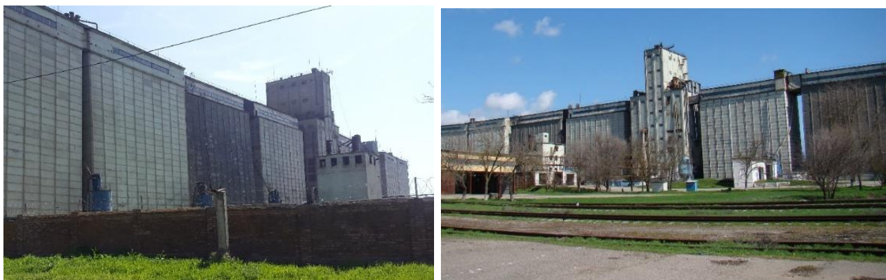
Рис. 6. Аварийные пустые силкорпуса элеватора.
