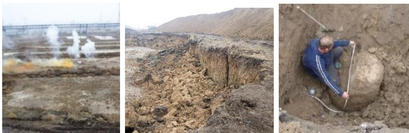
Рис. 11. Уплотнение просадочных грунтов на площадке строительства Газоперерабатывающего завода: гидровзрывным способом, буронабивными грунтовыми сваями.
