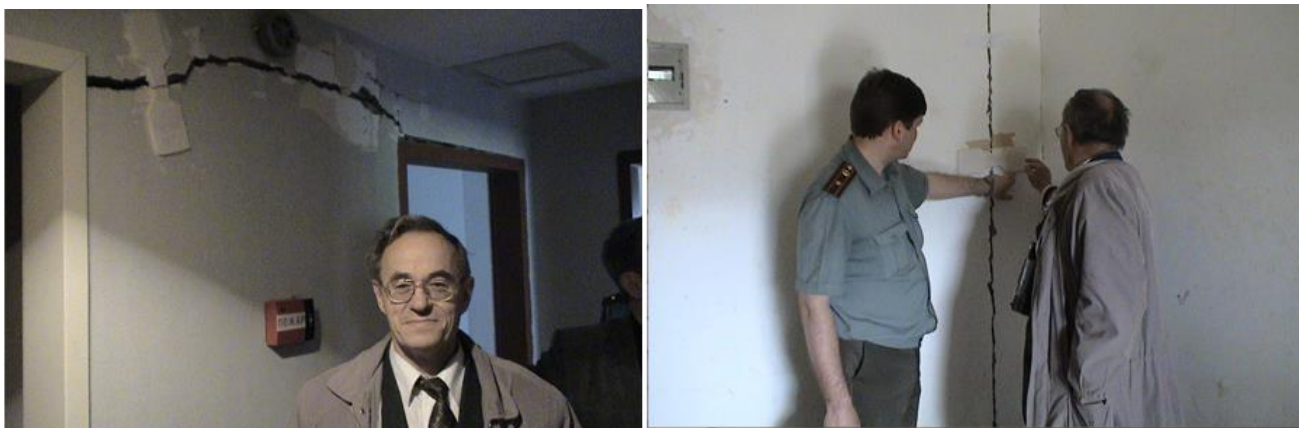
Рис. 7. Аварийные деформации зданий военного городка «Северный».
