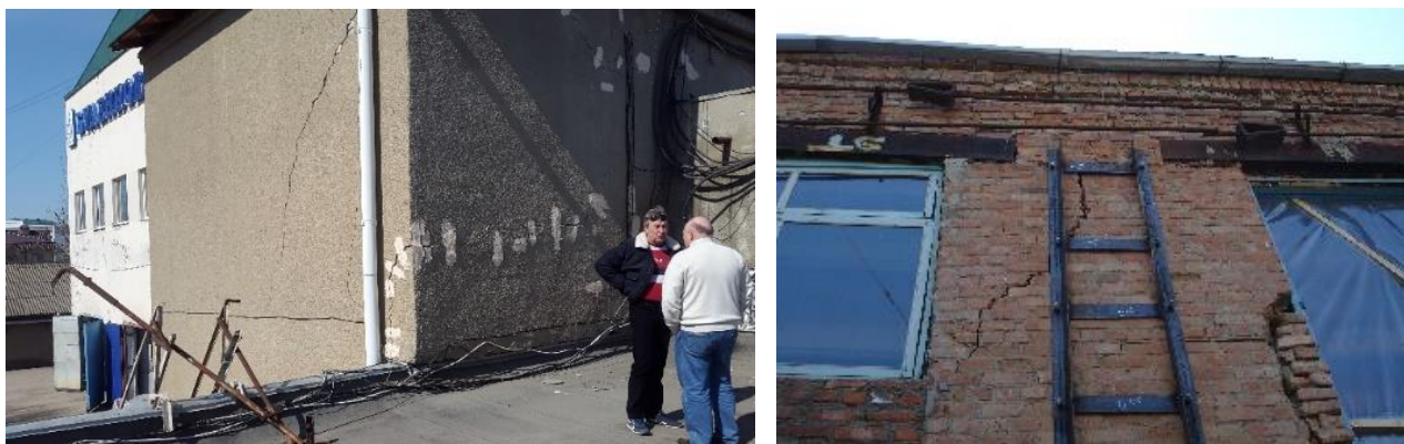
Рис. 5. Аварийные деформации Молочного завода.
